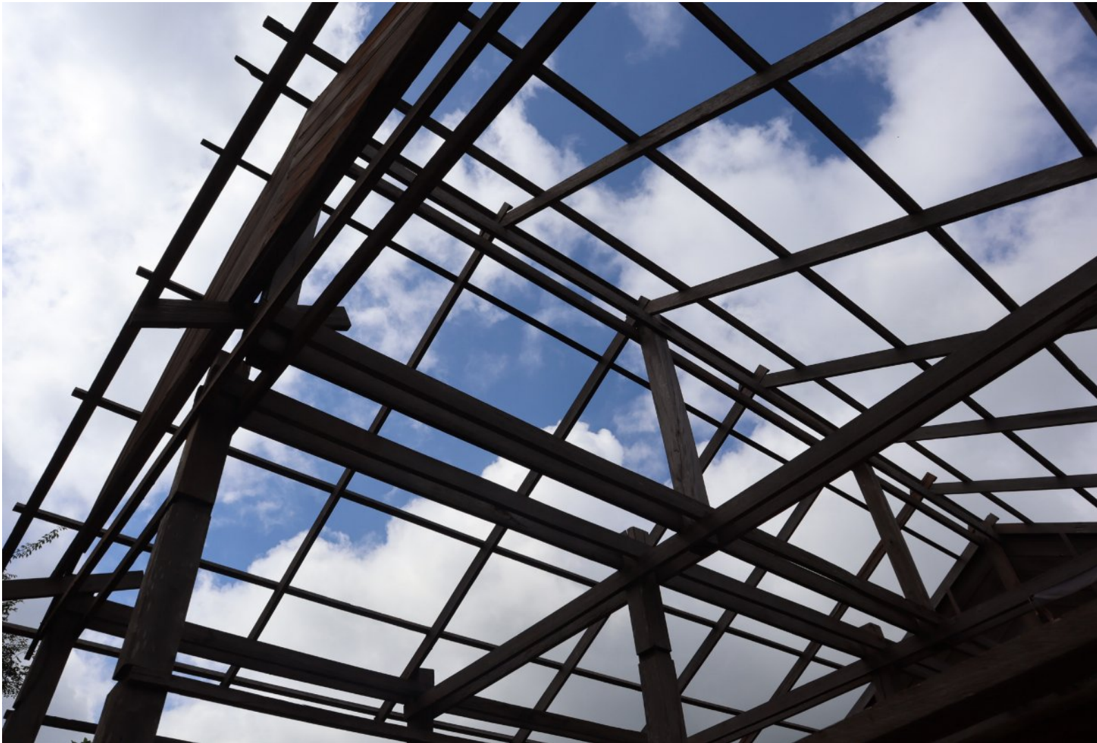
<사진 11> 자재를 마련할 수 없어 공사가 중단된 피해자의 집 ©손고운(한겨레21)
